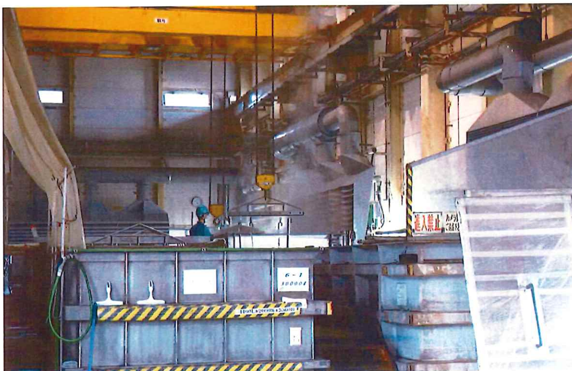
仁科工業の超大型無電解ニッケルめっき槽（埼玉県久喜市）
